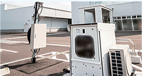
Edge data center solution DX edge
